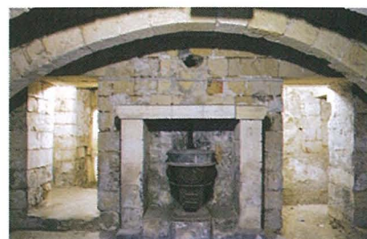
▲ Kaldarun li kien jintuża fis-sistema tas-central heating f'parti mill-Berġa fi żmien l-Ingliżi
